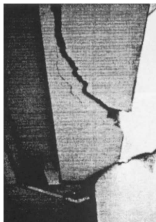
FIG. 1.14 - Dommages sur élément en béton - séisme au Salvador (13 janvier 2001)
