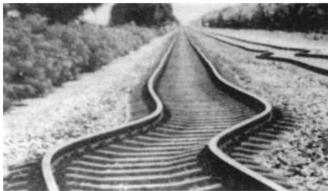
FIG. 1.5 – Déformation localisée de rails après le séisme de Tangshan (Chine) du 28 juillet 1976
