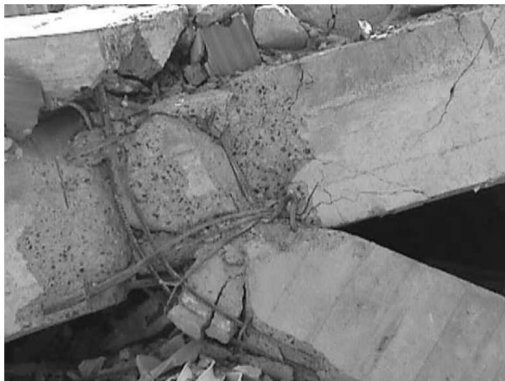
FIG. 1.12 - Rupture d'une liaison poutre/poteau - séisme d'Izmit (Turquie, 17 août 1999)
