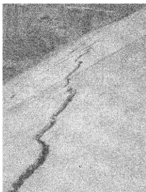
Figure 1.24 : Fissures sur la couche d'appui (2B) [Cao & Zhang, 2001]
