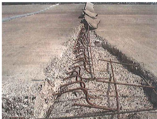
Figure 4.40 : Fissures (le long des joints verticaux) [Pinto, 2008]
