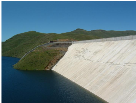
Figure 4.39 : Fissures horizontales sur le masque amont à l'élévation 2040 (Niveau du réservoir : 2010, Janvier 2003)
